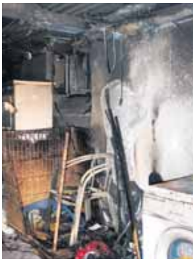
Der Kellerraum, in dem der Brand ausbrach.
